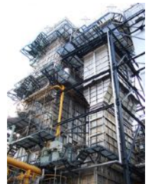
排煙脱硫装置
