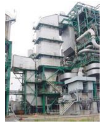
排煙脱硝装置
