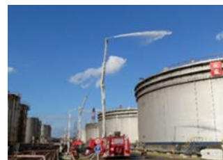
大型化学高所放水車（水島製油所）
