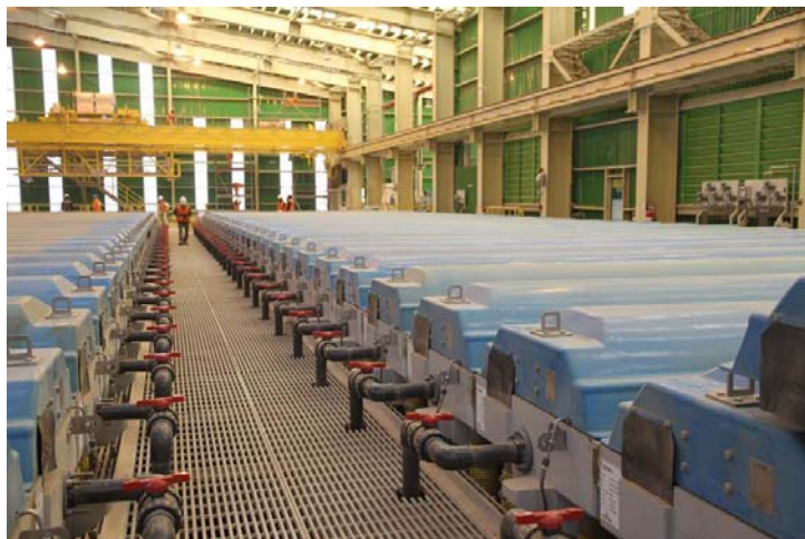
完成した電解採取設備
