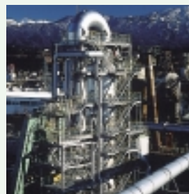
ガス化溶融炉
