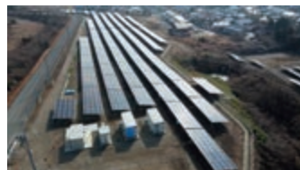
JRE福智金田太陽光発電所（蓄電池併設型）
