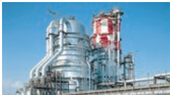
川崎製油所常圧蒸留装置
