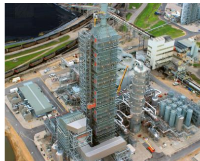
米国・CO 2 回収プラント
