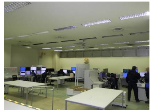
更新した制御システム
