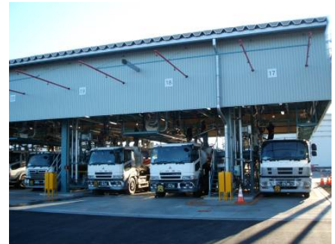
稼動を開始した東地区の新出荷設備
