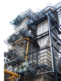
排煙脱硫装置
