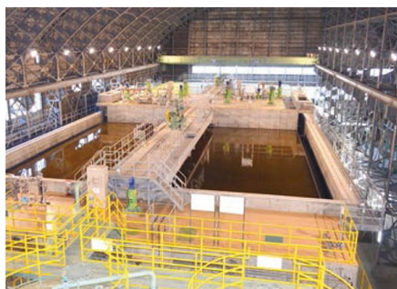
豊羽鉱山 本山坑廃水処理場の様子
