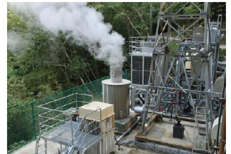
下田温泉バイナリー発電所
