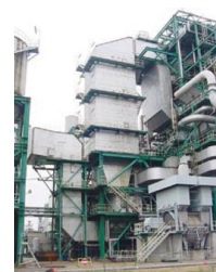
排煙脱硝装置
