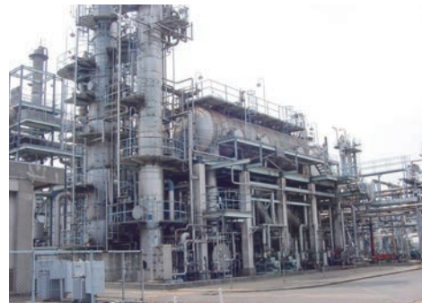
排煙脱硫装置
