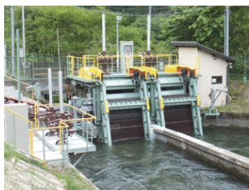
柿の沢水力発電所
