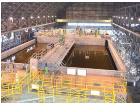
豊羽鉱山 本山坑廃水処理場の様子
