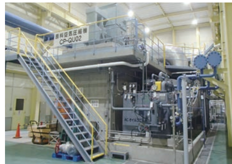
原料となる空気を圧縮する設備
