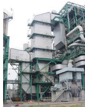
排煙脱硝装置
