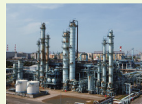
パラキシレン製造設備 (知多製油所)
