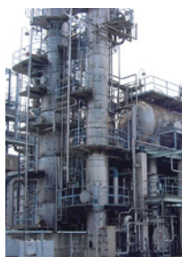
硫黄回収排煙脱硫装置 (水島製油所)
