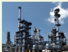
サルファーフリーガソリン製造設備 (水島製油所)
