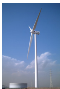
風力発電設備(鹿島製油所)
