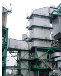
排煙脱硝装置 (水島製油所)
