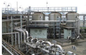
活性炭吸着による排水処理施設
