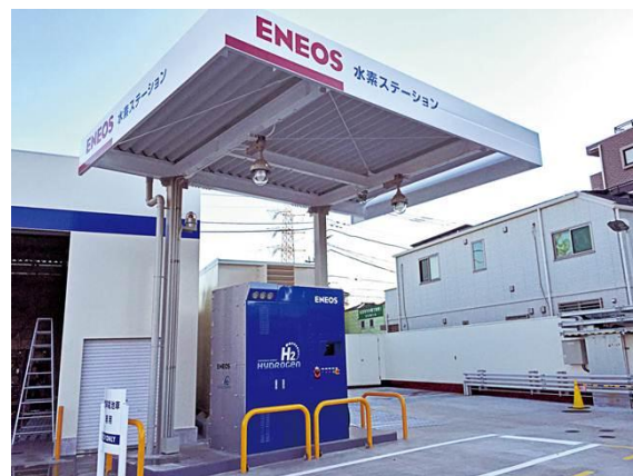
<水素充填機の設置状況>
